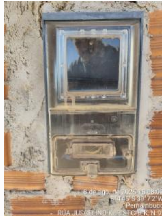
Sem medidor de energia
